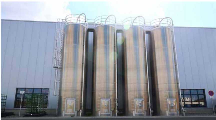
Vom großen Außensilo bis zur Spritzgussmaschine – die nachhaltige Materialtrocknung und -logistik bei Gerhardi kommt komplett aus einer Hand.
