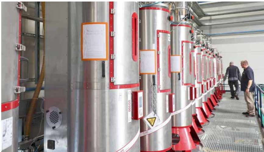
Nachhaltige Materialtrocknung und -Logistik: Die Drucklufttrockner von Wenz qip arbeiten energieeffizienter als die sonst eingesetzten Adsorptionstrockner.
